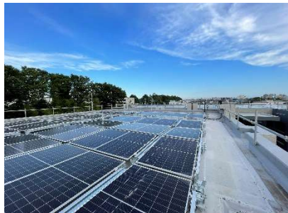
太陽光発電設備
